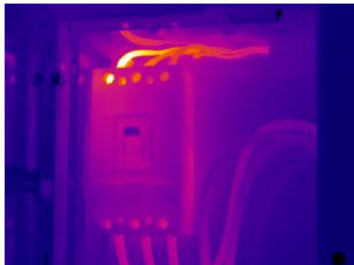
Problema di giunzione dell'interruttore
