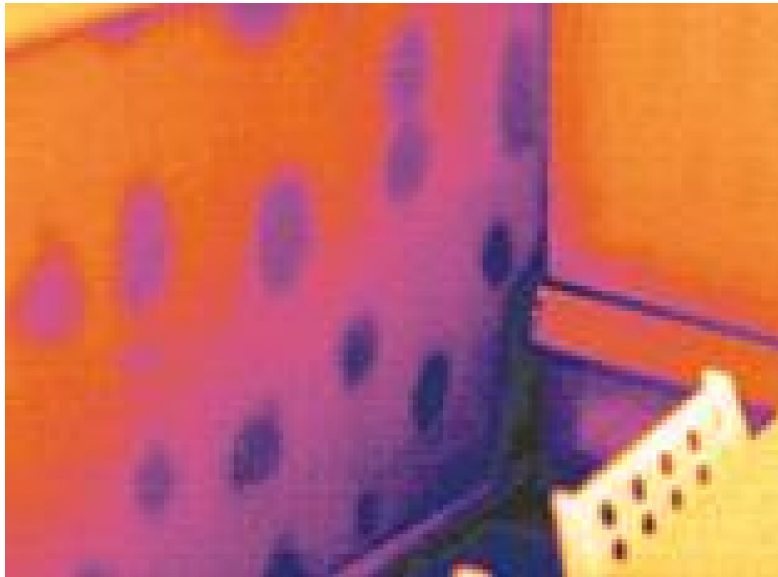
Presenza di muffe sulla parete
